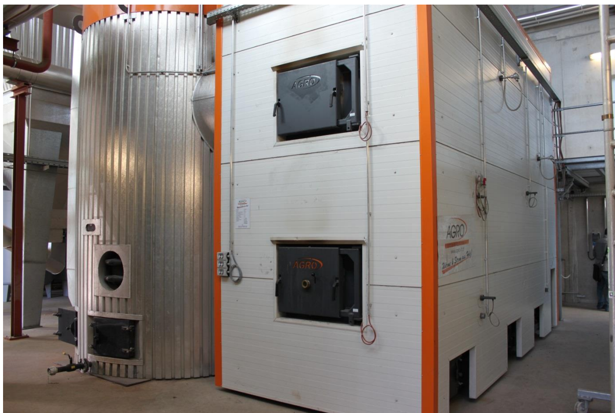
Obrázek 62: Středně velký systém vytápění na štěpku (výkon 3 000 kW) s kotlem (vpravo) a akumulací nádrží (vlevo) v Biomassehof Achental, Německo. (Zdroj: Rutz D.)
