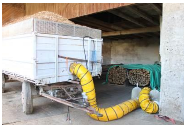
Obrázek 50: Kontejnerová sušárna na přívěsu. Sušárna využívá odpadního tepla z bioplynové stanice, Německo. (Zdroj: Rutz D.)
