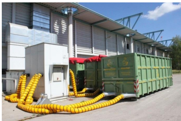
Obrázek 48: Kontejner se vzduchovým potrubím pro sušení dřevní štěpky pomocí odpadního tepla z bioplynové stanice v Mnichově, Německo. (Zdroj: Rutz D.)
