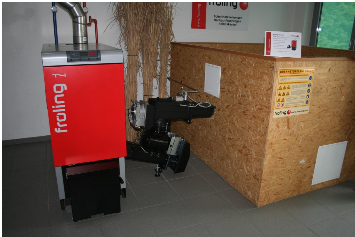
Obrázek 61: Malý systém vytápění na pelety (výkon 24-50 kW) s kotlem (vlevo), dávkovací zařízení (uprostřed) a zásobník na štěpku (vpravo) od firmy Fröling. (Zdroj: Rutz D.)
