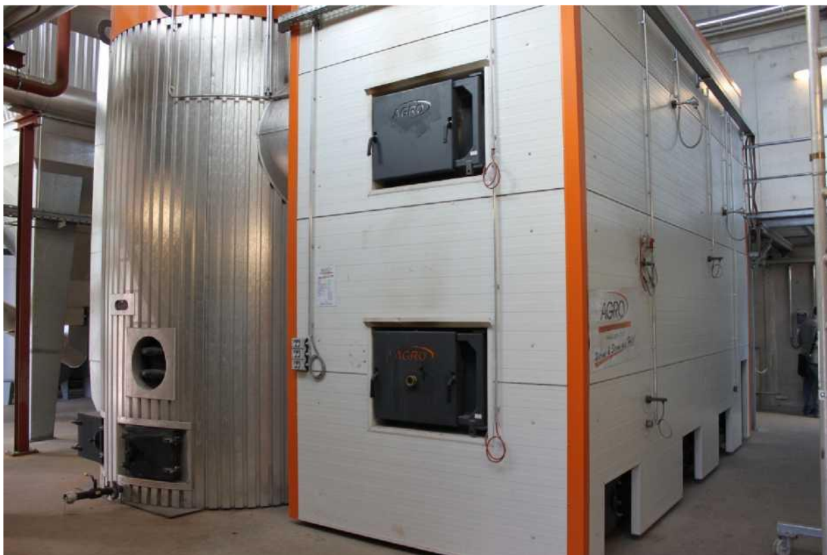
62.attēls: Vidēja izmēra šķeldas apkures sistēma (3000 kW jauda) ar apkures katlu (pa labi) un siltuma akumulācijas tvertni (pa kreisi), Biomassehof, Ahentāle, Vācija (Avots: Rutz D.)
