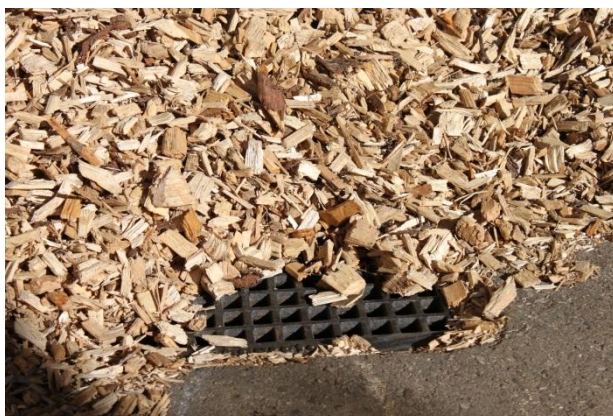
Слика 51: Вентилација во подот на објектот за складирање во Центарот за трговија со биомаса во Ахентал, Германија (види Слика 52) (Извор: Rutz D.).
