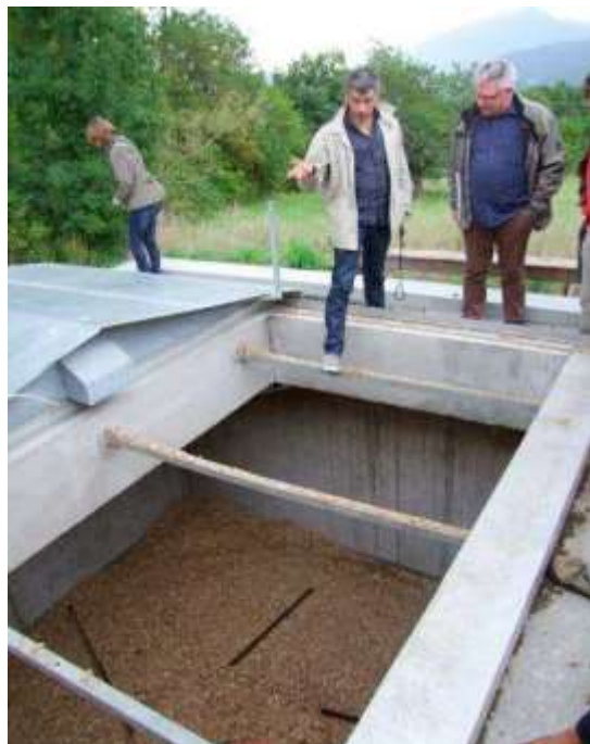
Εικόνα 6. Επίσκεψη σε σύστημα θέρμανσης με θρυμματισμένο ξύλου (θερμαίνει δημοτικά κτίρια, τη βιβλιοθήκη και 3 διαμερίσματα του δήμου) στο Le Percy
