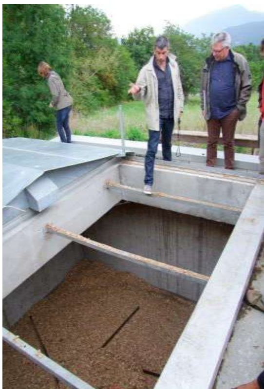
Obrázek 5: Centrální kotelna na vytápění dřevní štěpkou 3 pro obecní budovy a 3 obecní byty v Percy.
