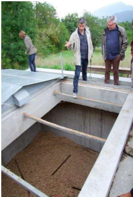
Слика 6: Посета на систем за греење со дрвен чипс (греење на општинска зграда, библиотека и 3 простории на Советот на општината) во Le Percy
